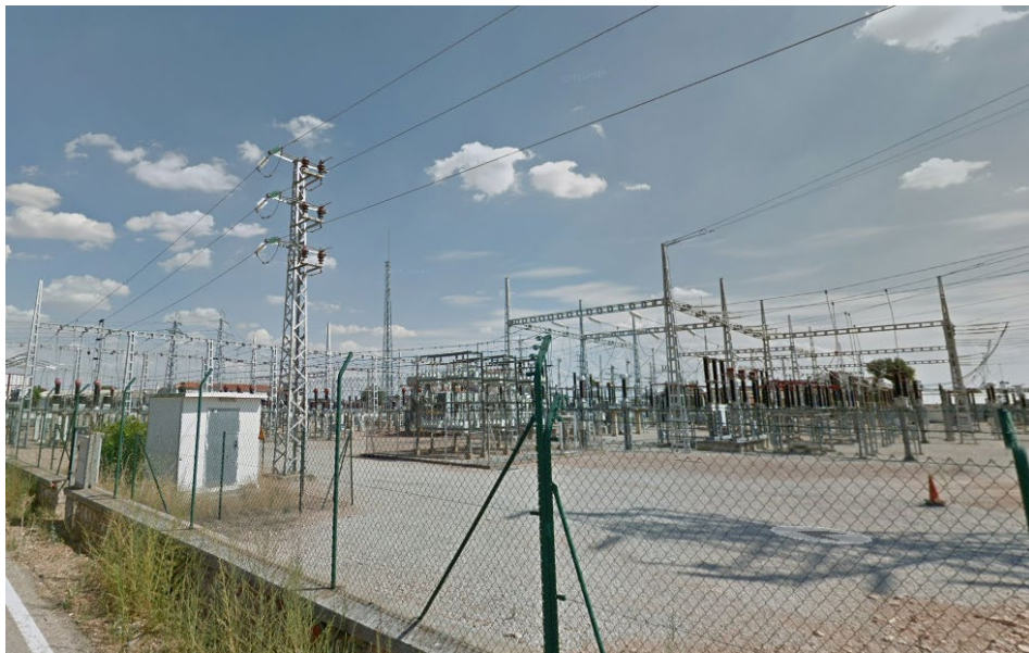
Figura 23: Subestación eléctrica La Paloma [Google MAPS]
